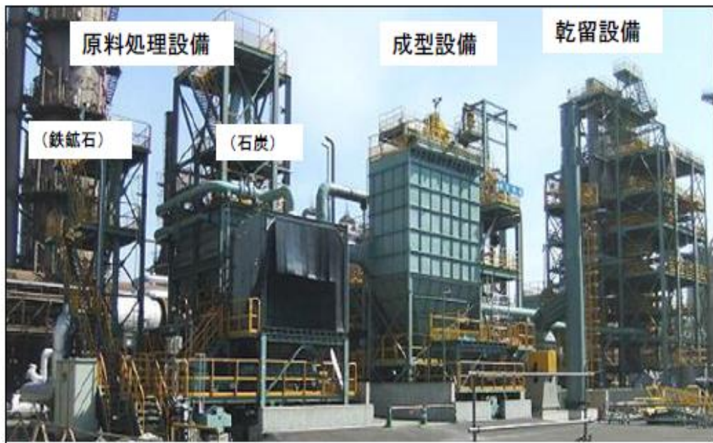
30t/dパイロットプラント全景
