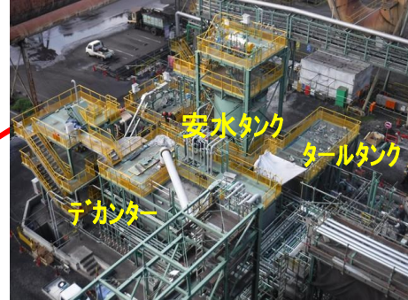
安水・タール処理
