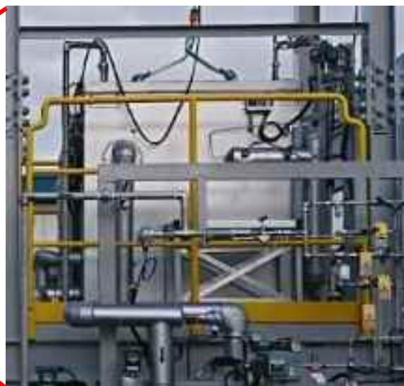
膜エレメント設置部
