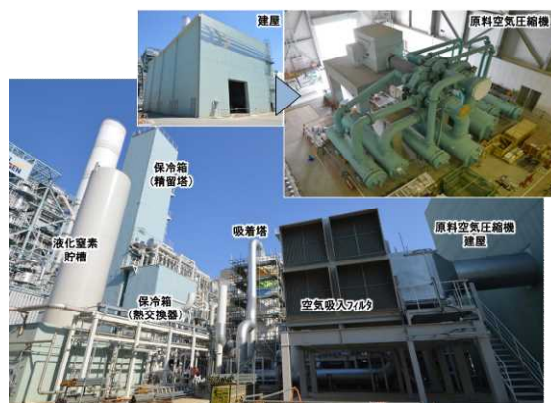
図 3-15 空気分離設備
