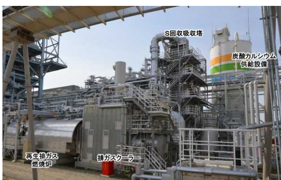
図 3-9 硫黄回収設備
