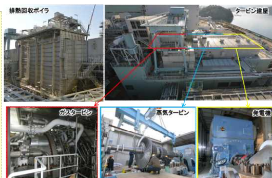
図 3-11 複合発電設備
