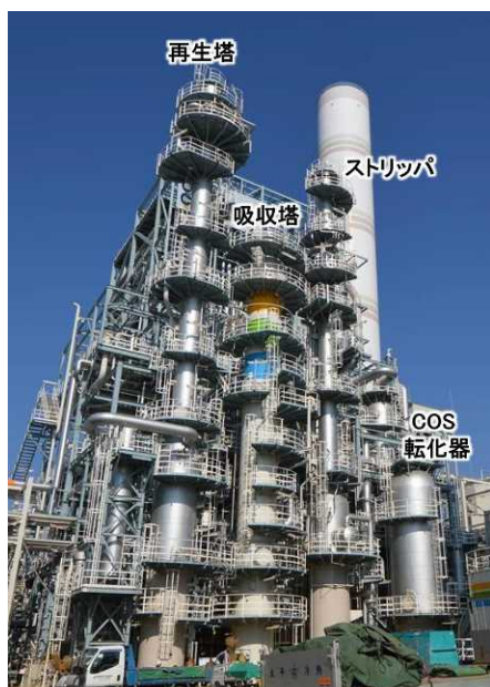
図 3-8 ガス精製設備
