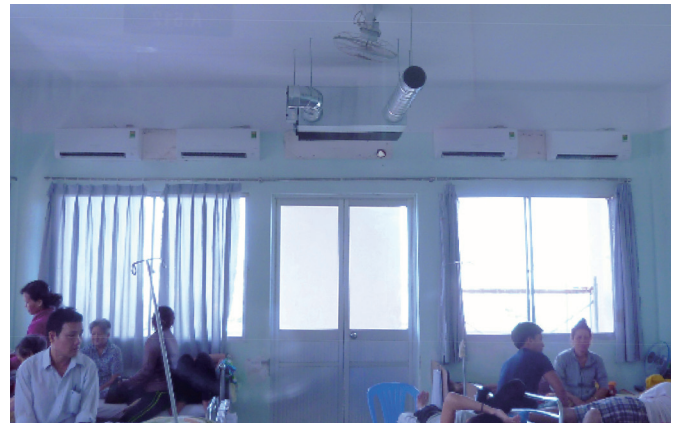
病院に導入したインバーターエアコン / Điều hòa không khí kiểu biến tần được lắp đặt tại các bệnh viện
