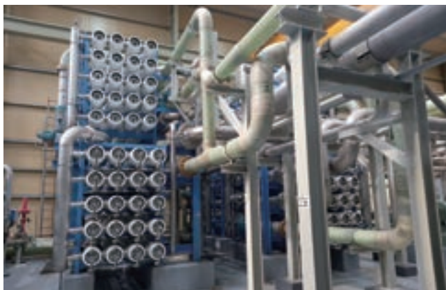
省エネルギー型海水淡水化システムプラント(サウジアラビア)
