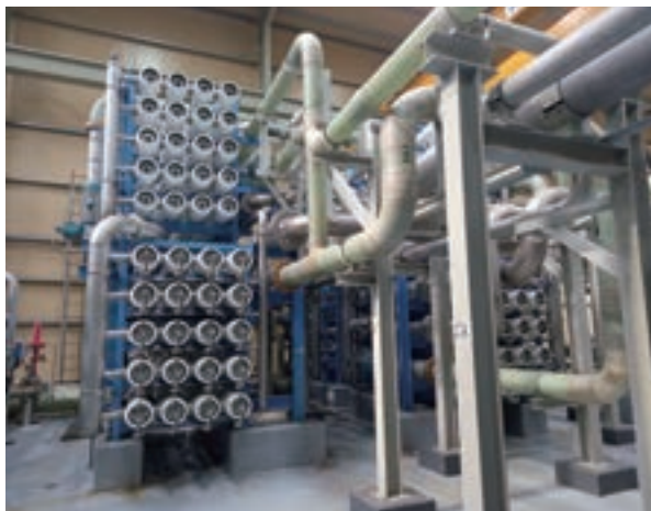
省エネルギー型海水淡水化システムプラント (サウジアラビア)
