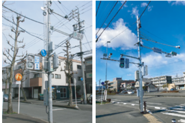
【AI交通信号機の設置状況】
