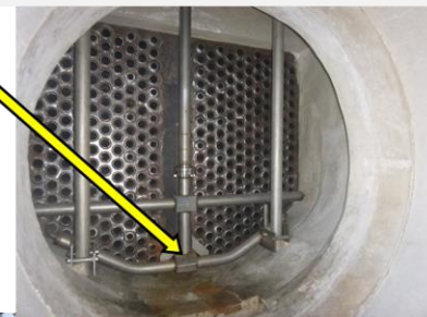
ボイラ内部 (燃焼ガス入り側)
