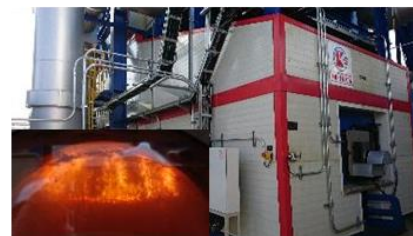
バイオマス燃焼炉
