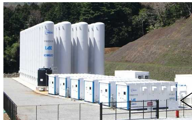
圧縮空気エネルギー貯蔵システム
