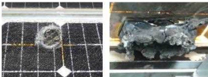
図Ⅲ-2-④-(1)-1 PVモジュール表面の破壊痕やガラス割れ、裏面のジャンクションボックスが焼損した様子
