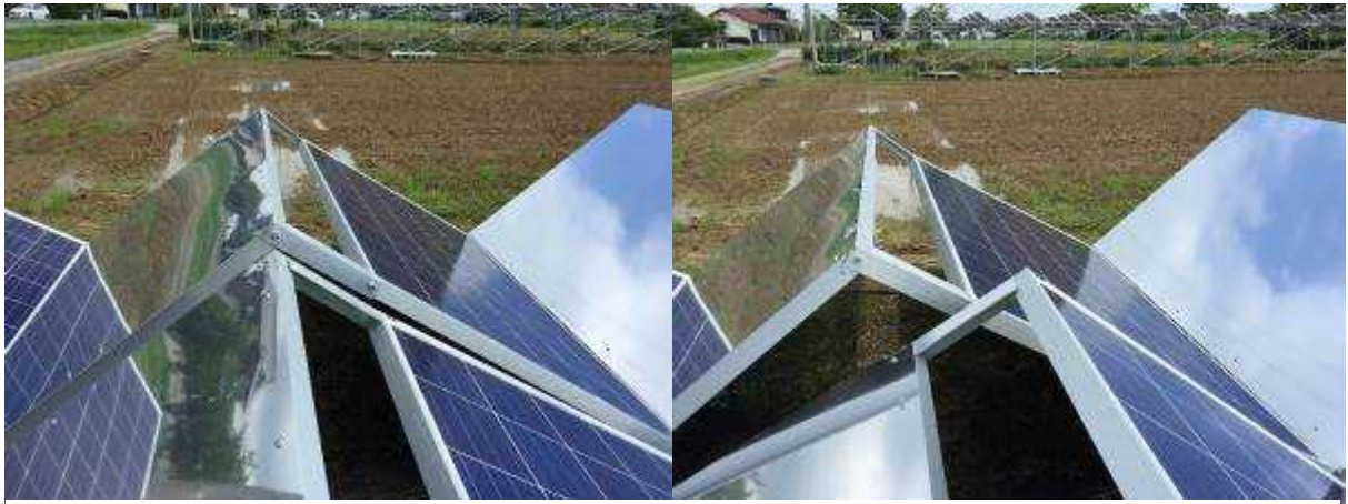
図Ⅲ-2-①-(3)-6 角度可変の反射板を取付けした架台
