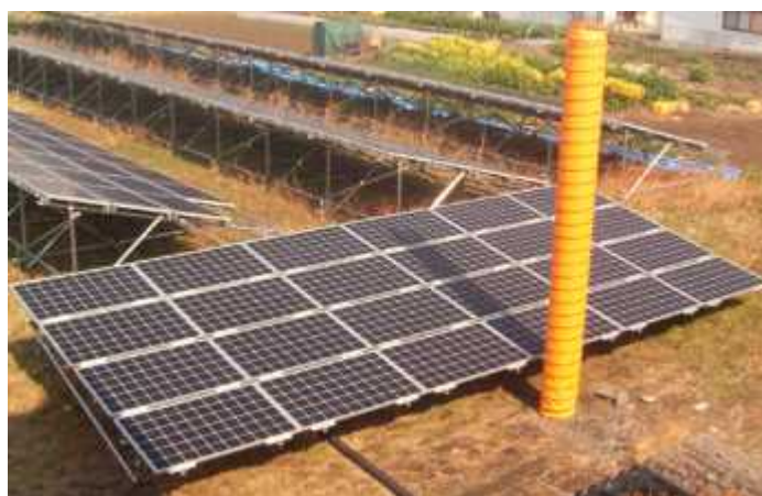
図Ⅲ-2-①-(1)-14 実証システムの写真
