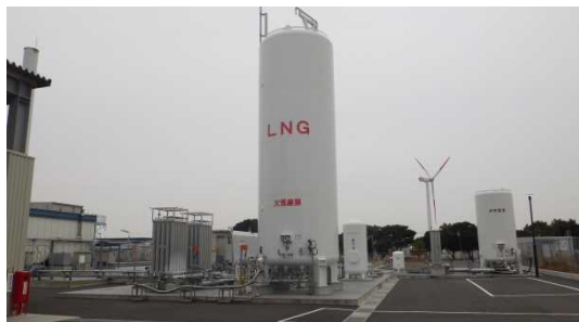
(a) LNG/N 2 供給設備
