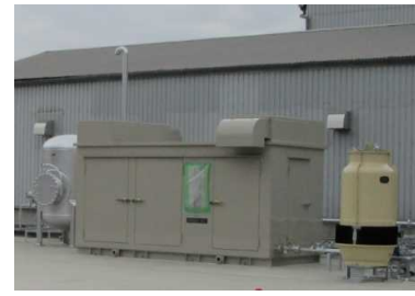
都市ガス圧縮機
