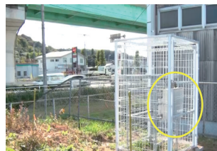
走行車両による振動や電磁ノイズが大きい環境(設置場所①)
