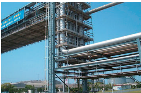
足場の組まれた高所配管
