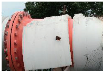
保温材付大型配管
