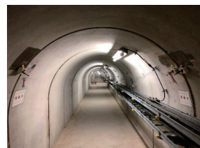
ダム内の監査廊内に設置
