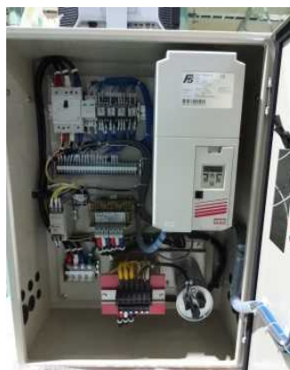
(d) 操作盤外観
