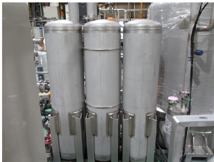
図 2.1.1-7 バッファタンク
