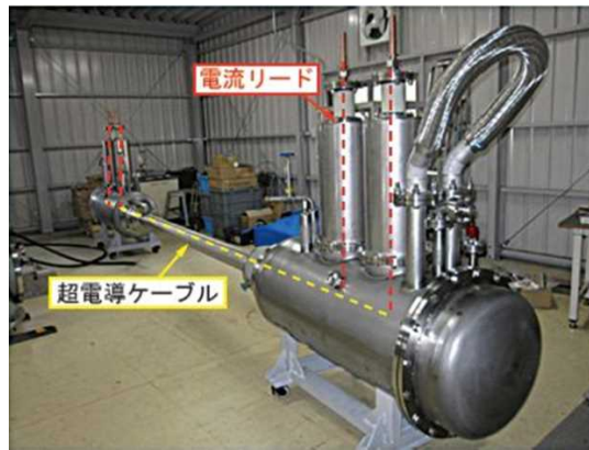
図 2.1.4-1 超電導き電線用電流端末
