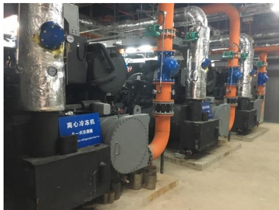
INVERTERターボ冷凍機 (三菱重工) 1500kW(426USRT) × 3台
