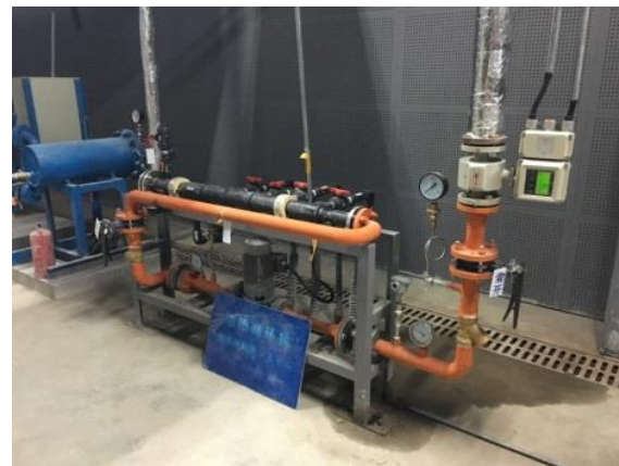
地中熱利用設備ポンプ
