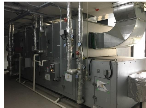
デシカント空調機 (クボタ) 8000m 3 /h × 4台
