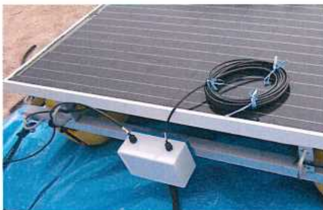
Ⅲ-2-①-9-6 漏電遮断リレー取り付け写真
