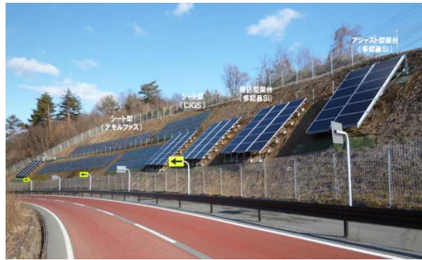
図Ⅲ-2-①-6-11 構築後の実証設備
