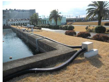
図Ⅲ-2-①-8-13 配管・配線①
