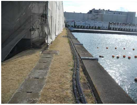
図Ⅲ-2-①-8-16 配管・配線③
