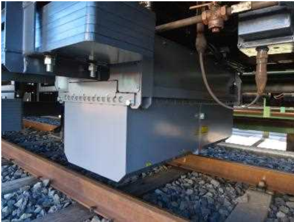
図Ⅲ-2-②-10-20 軌道変位常時監視システム
