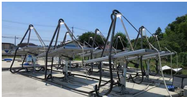
図Ⅲ-2-③-13-8 八街実証設備の総合運転の様子
