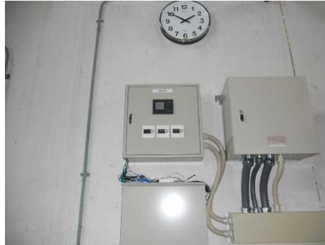
図Ⅲ-2-①-8-19 絶縁監視装置
