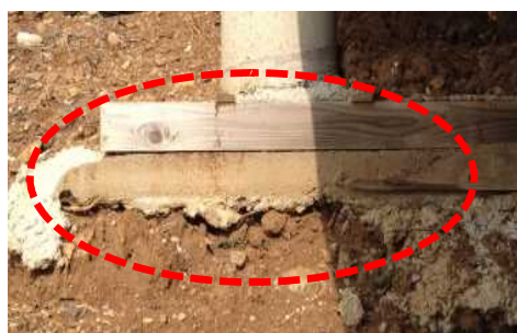
図Ⅲ-2-①-7-16 コンクリート基礎の洗掘 出所：当社調べ
