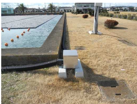
図Ⅲ-2-①-8-14 配管・配線②
