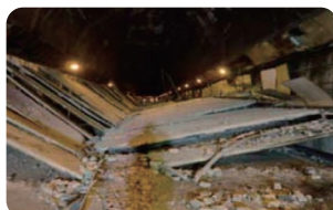
中央自動車道笹子トンネルでの天井陥落事故(2012年12月) 出典:東山梨消防本部 災害活動レポート「笹子トンネル天井版陥落災害の概要と消防機関の対応について」消防科学と情報 No.112_2013(春季)
