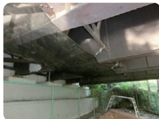
はく落防止ネット
