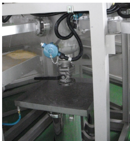
図Ⅲ-2.2.2.4-12 冷却シャワー
