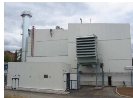
<H-25熱電併給設備>
