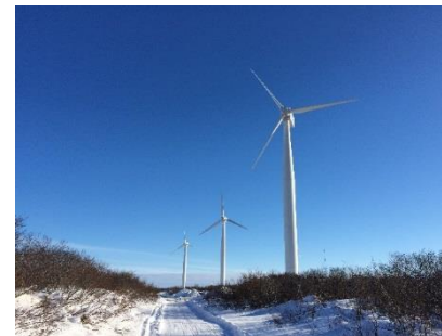
稼働中の風力発電システム (平成28年1月)
