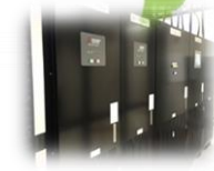
高電圧直流給電システム (アメリカ)
