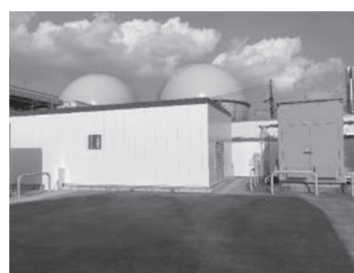
(b) 水素製造設備
