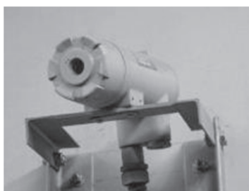
(d) 耐圧防爆型炎検知装置
