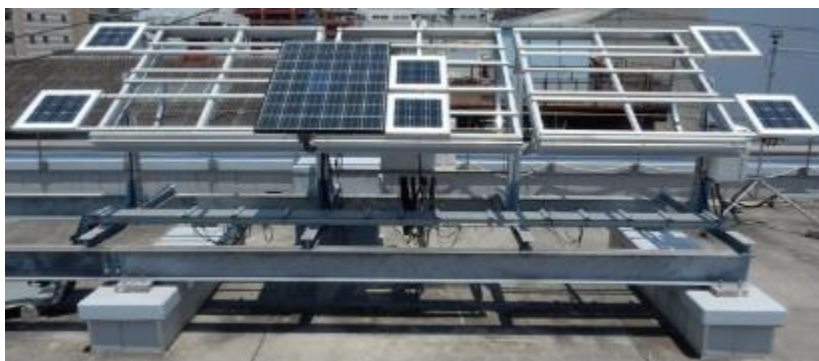
図Ⅲ-2-(ホ)-2-⑦-1 JET 屋上における測定系。
