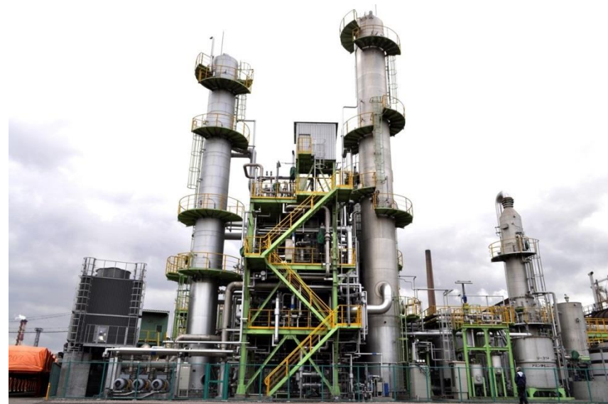
図 ESCAP設備の外観
