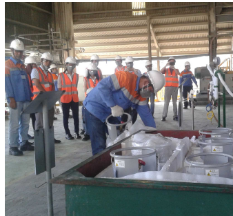
回収したフロンをセメント工場のキルンに注入し、破壊
