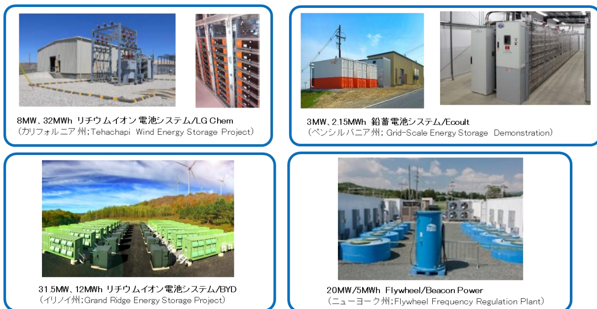
図 I -15 米国に導入されている大規模蓄電システムの例
