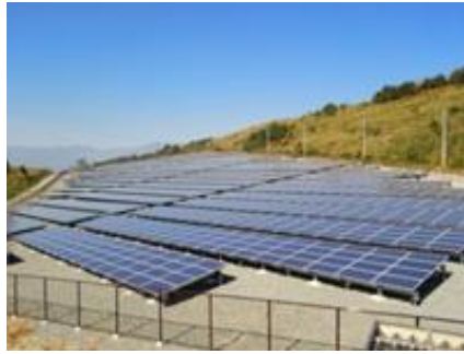
山梨県米倉山実証試験用太陽光発電所
