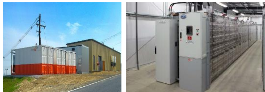
3MW/2.15MWh 鉛蓄電池システム/Ecoult (ペンシルバニア州; Grid-Scale Energy Storage Demonstration)
