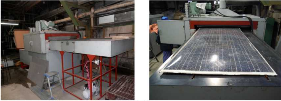
図Ⅲ-2-②-(3)-3 ロール式破砕機 (左：外観、右：投入状況)
