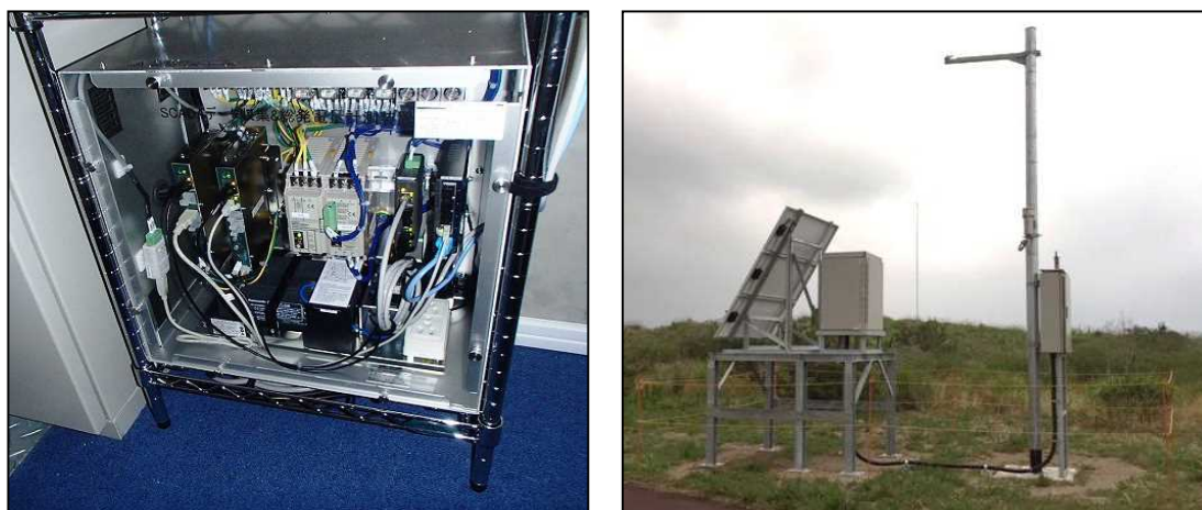
図Ⅲ.2-1-1. モニタリングシステムの一例（左：SCADA/総発電計測装置、右：気象観測装置）
