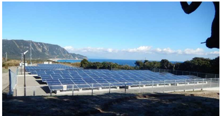
大原太陽光発電所(315kW)
