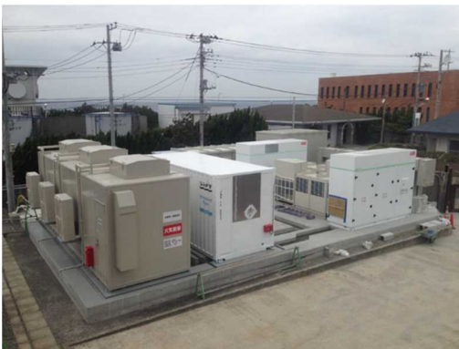
発電所内の系統用蓄電池(1,000kWh)
