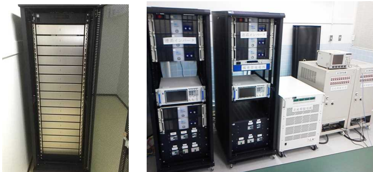
図Ⅲ. 2-2-12 大阪府立大学における蓄電池システム（リチウムイオン）
