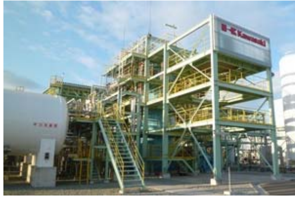
図4 実証試験中の水素液化システム外観
