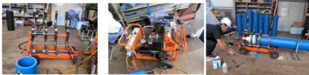
写真左より、溶着機、溶着機制御部、鏡部とPE管をセットした所。写真右：鏡部とPE管のレベルを測定し、樹脂ライナーの芯を合わせる(簡易レベリング法)
