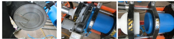
写真左より、表面研磨機：溶着部を平滑にするためのカッター。鏡部とPE管の端面研磨：かな掛けの為、薄いカットされた切りくずが出てくる。研磨端面の写真。きれいに端面が研磨されているのがわかる。
