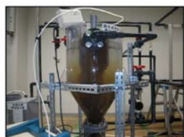
逆洗排水濃縮状況 (フッ素分離、再利用汚泥濃縮)
