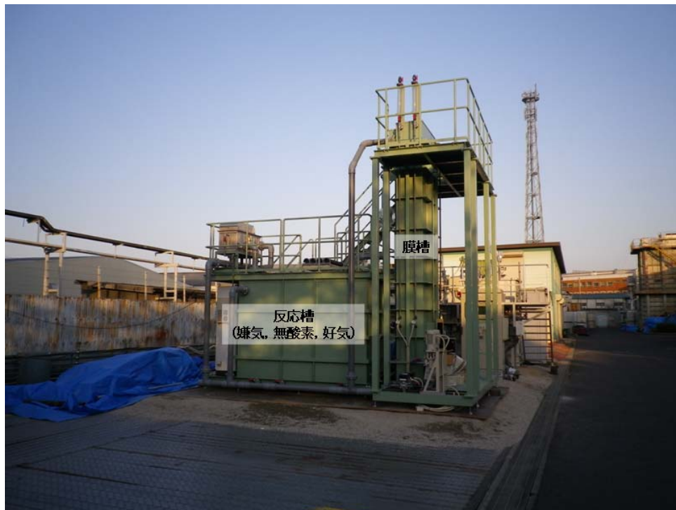
図Ⅲ. 2. 4. 1-69 パイロット試験装置の外観
