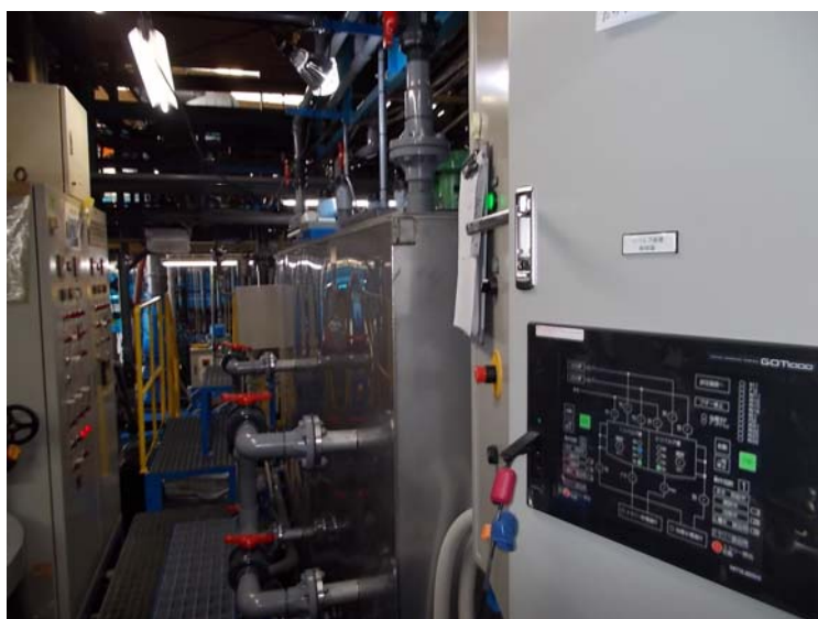
図Ⅱ.2.1.6.2-7 リパルプ洗浄槽（右中央：リパルプ洗浄槽、右手前：同装置配電盤）
