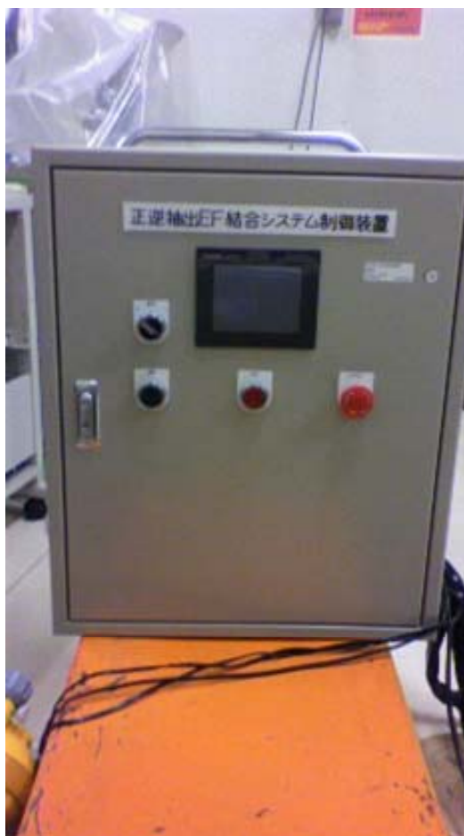
図Ⅲ. 2. 6. 1-94 正抽出・逆抽出同時進行システムについての電子制御盤
