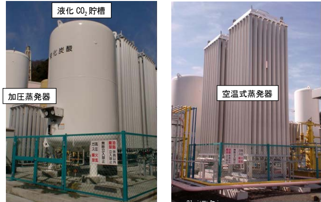
受託研究で追設したCO 2 供給設備
