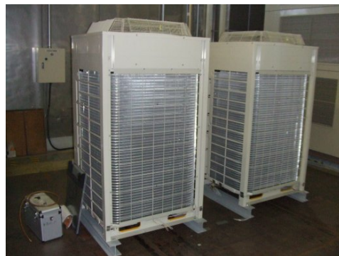
室外機(冷暖同時機)
