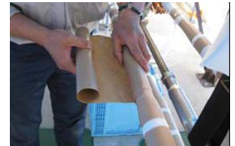
4. ケーブル導体接続
