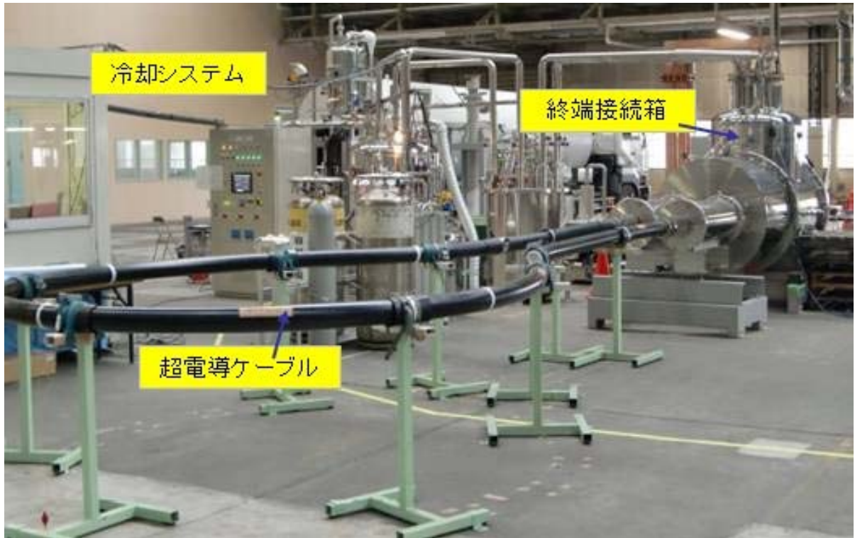
図 2.2.1-46 検証システムの全景
