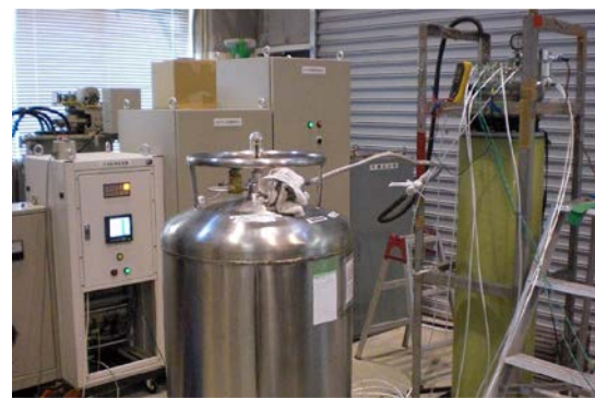
図 2.3.3-5 4巻線構造変圧器 (保冷容器内部) と試験装置
