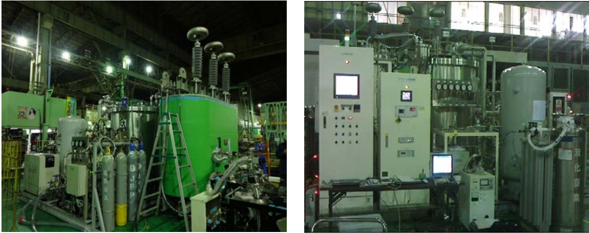
図 2.3.5-17 2MVA 級変圧器モデル、冷却システム外観写真
