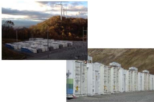
32MWプラント@米国WV州ベリントン (AES Energy Storage社/A123社 リチウムイオン電池)
