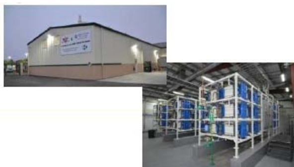
600kW/3.6MWhプラント@米国CA州Gills Onions (Prudent Energy社 レドックスフロー電池)
