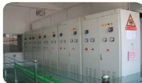
1MW/4MWhシステム (BYD社 リチウムイオン電池)
