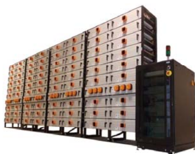
360kW/90kWhシステム (EnerDel社 リチウムイオン電池)
