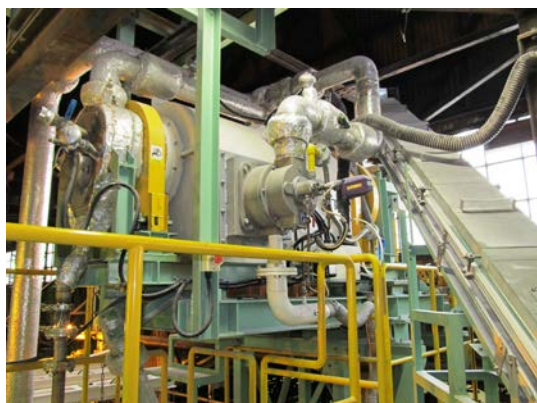
図Ⅲ-2-②-2-2 導入したロータリーキルン
