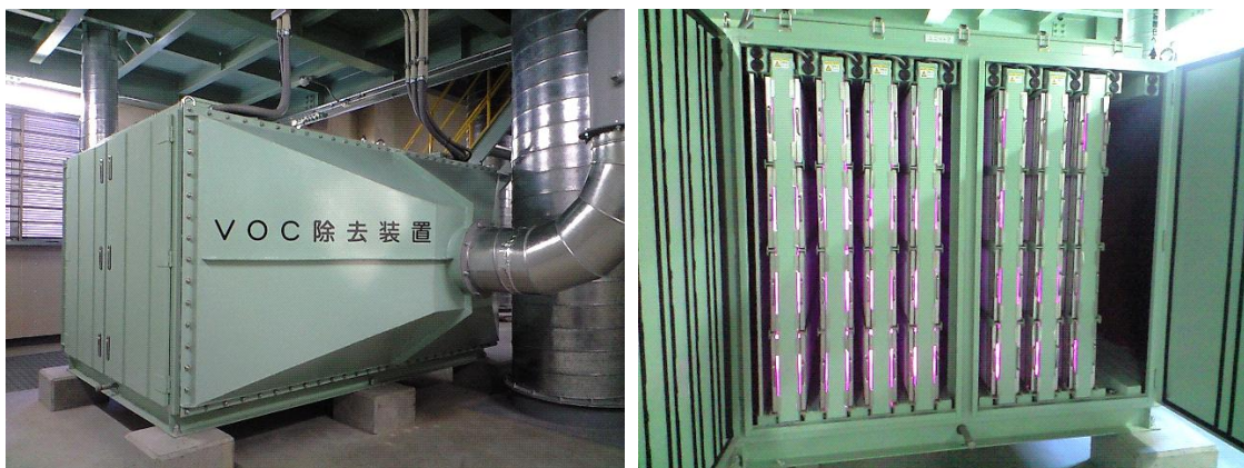
写真 14段フィルターを有する VOC 除去装置 (左：全景 右：内部)
