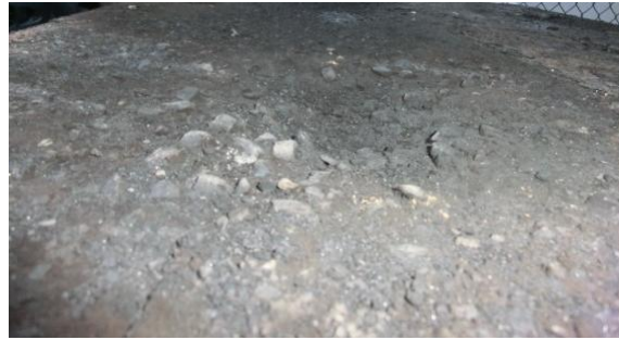
図15 アスファルト路面の損傷状況
