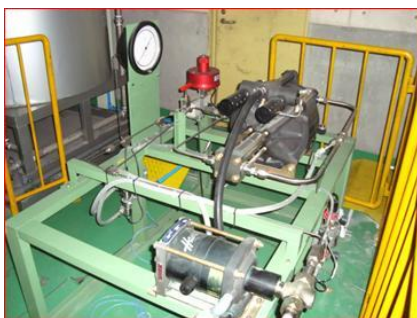
図14 破裂試験用高圧ポンプ
