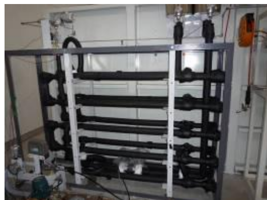
熱交換器（試験装置）
