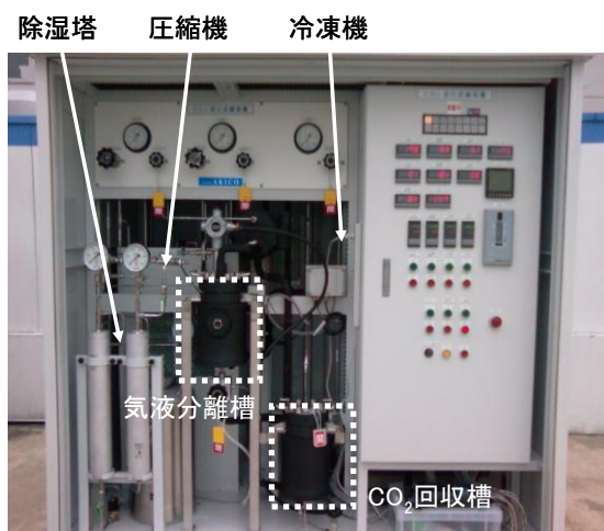
図9 CO 2 分離回収装置外観
