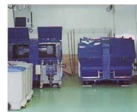
ビルのゴミ処理室
