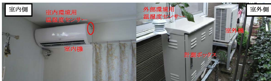
図 4.2.1 エアコンおよび計測ボックスの設置状況（新潟県の某モニター邸にて）
