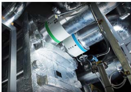
水和物スラリによる 省エネ冷房システム
