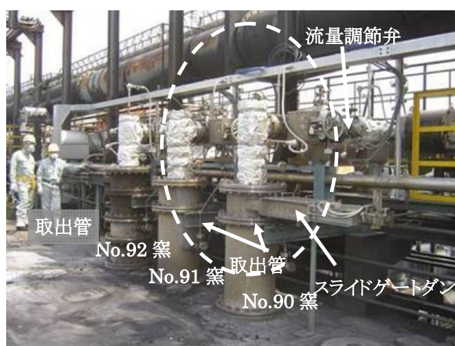
図Ⅲ-22 3門に増設した高温 COG 取出管付近外観
