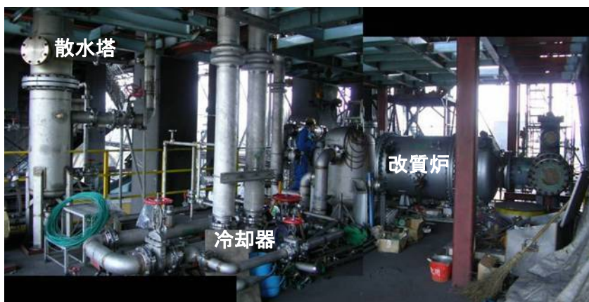
図Ⅲ-6 パイロット試験装置外観(試験用鉄骨架台2階床面に設置した主要機器)
