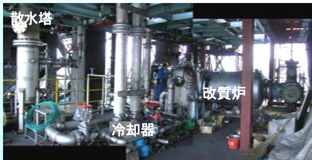
コークス炉建屋中間デッキ専用架台に据付完了した試験装置
