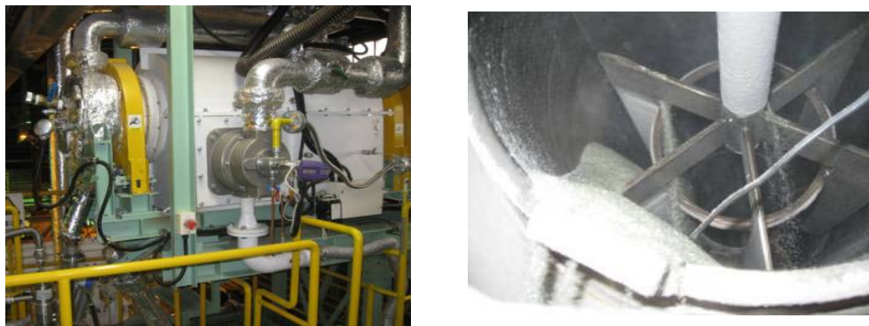
図Ⅲ-2-B1-1. カレット予熱装置の外観と内部
