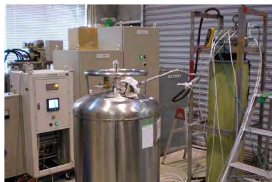
図 2.3.3-5 4巻線構造変圧器 (クライオスタット内部) と試験装置
