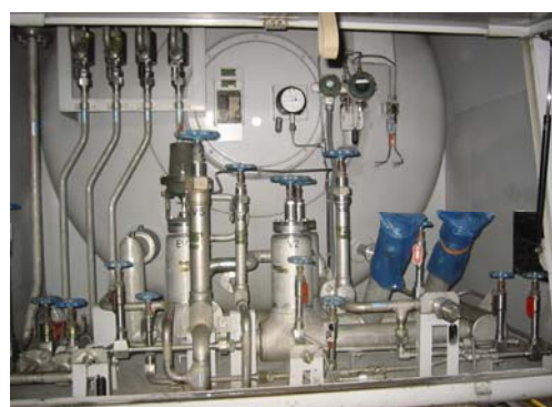
図III 2.3(2)10-2 上から、解体調査に供した液体水素ローリー（15ton トラック）、ステンレス鋼製内容器、台車後部の付属部品
