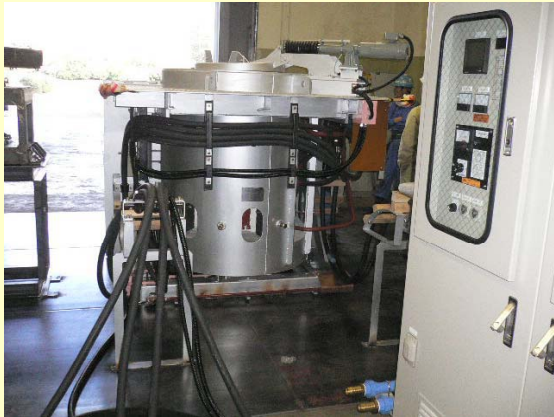
150kW誘導加熱溶融炉
