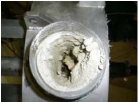
ダクト閉塞状況
