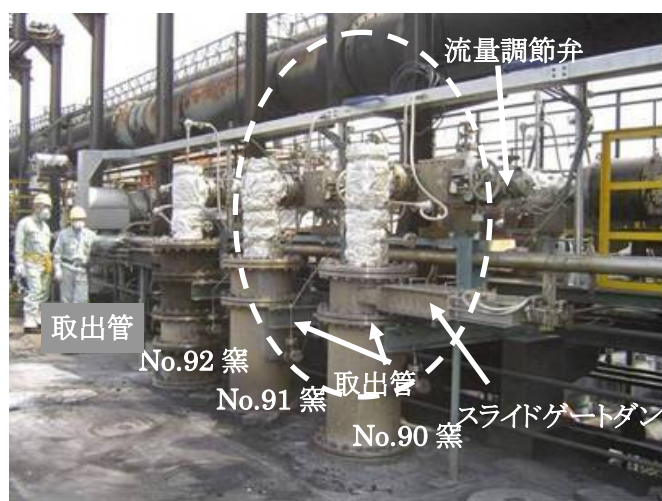
図Ⅲ-22 3門に増設した高温 COG 取出管付近外観
