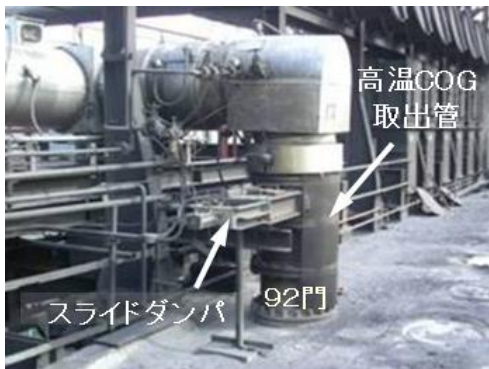
図Ⅲ-4 高温COG取出管外観(コークス炉上)
