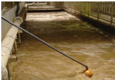
工業廃水、火力発電所廃水処理槽
