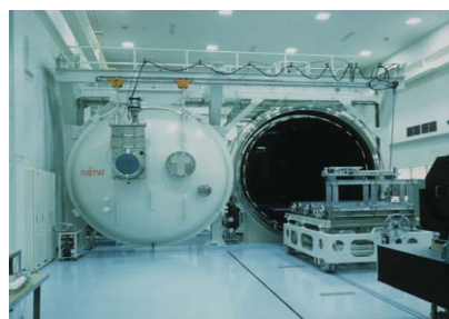
スペースシャワーコールドパネル冷媒供給
