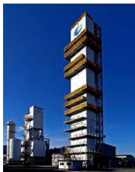
石油ガス・希ガスの 極低温蒸留分離装置
