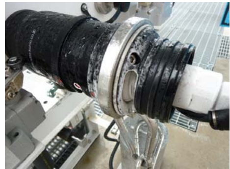
図5 充填カプラーの着霜状況
