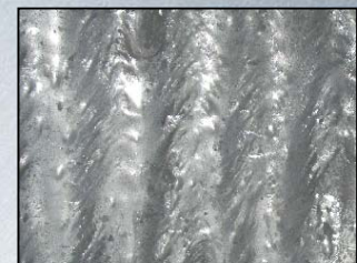
ガス化炉壁表面 (表面はスラグでコーティング)
